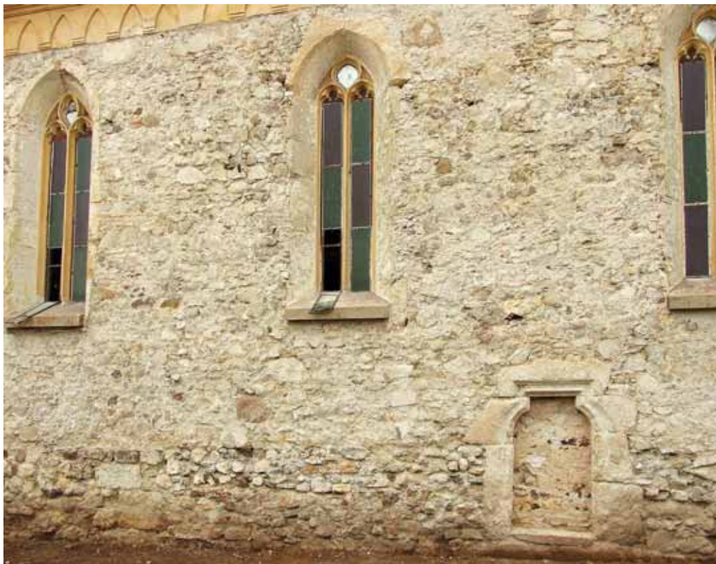
3. A déli homlokzat részlete helyreállítás előtt
